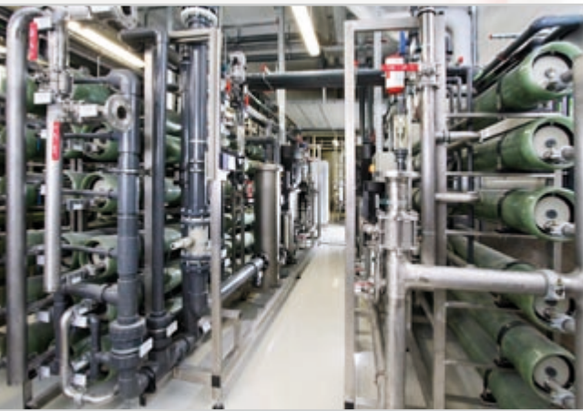
Großtechnische Umkehrosmoseanlage Large-scale reverse osmosis plant
